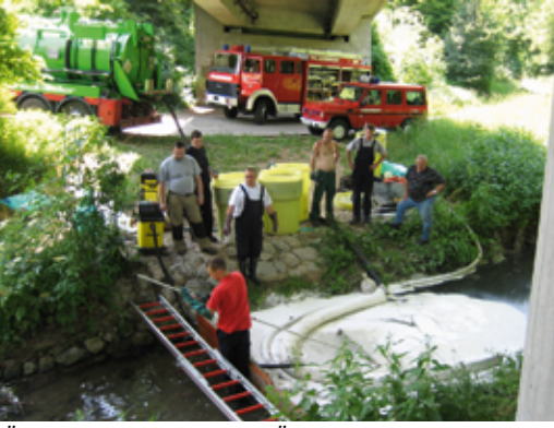
Ölsperre und Absaugen von Öl (von der Autobahn) am Gründelbach am 14.06.2006
